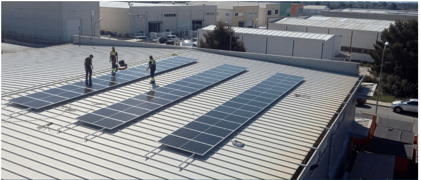
Plaques fotovoltaïques de la nau de la brigada.
